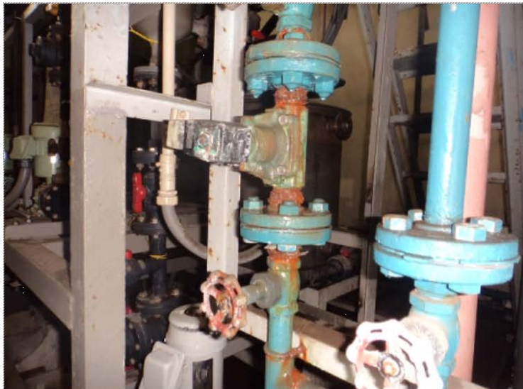
高分子タンク給水配管
