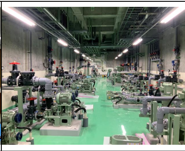
■処理棟地階 ポンプ室
